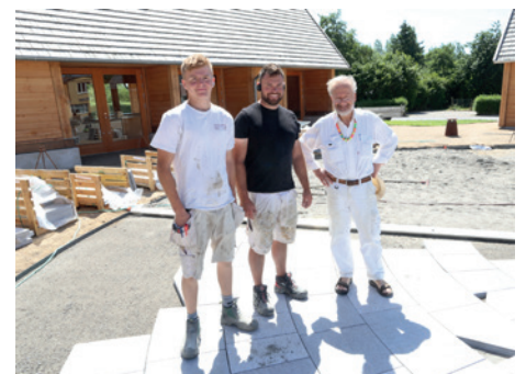
Granitbelægningen var færdig i juli 2025. Her står Bjørn Nørgaard på pladsen sammen med Buster og René, der har lagt de mange sten.
